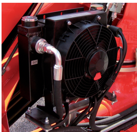
Refroidissement huile hydraulique sur grue de chargement : Refroidissement à air avec moteur à courant continu
