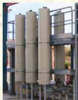
Amortisseur de coups de béliers pendant le chargement d'un camion dans dépôts de carburant grâce à des accumulateurs à piston .
