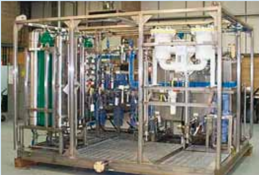
Filtre et accumulateur dans unité haute pression UHP.
