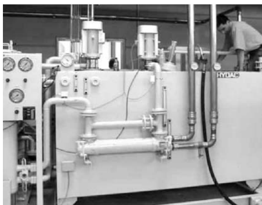
Während des Probebetriebs übertraf die Aufbereitungsanlage von HYDAC alle Erwartungen.
