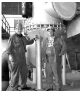
Stolz auf die erfolgreiche Inbetriebnahme der HYDAC Filteranlage in Kocice/Slowakei: Herr Tesla und Herr Oravec vom Montage-Team.
