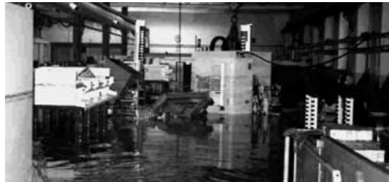
Wasser, wohin das Auge blickt: „Land unter“ in einer Werkzeugmaschinenfabrik während des Elbhochwassers.
