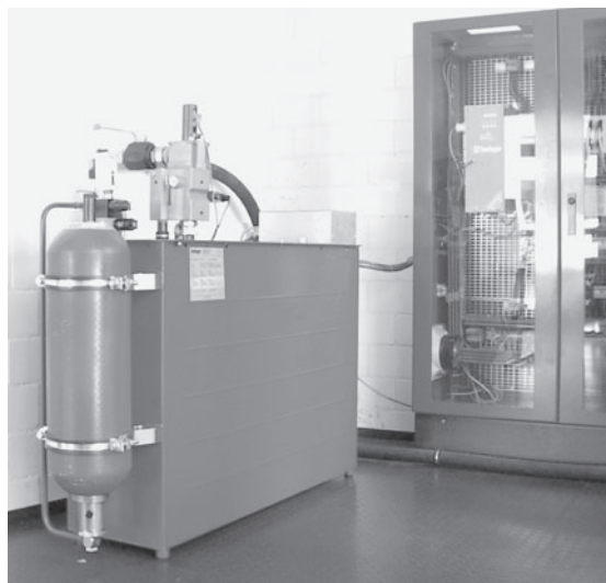
Das Herzstück zum Erreichen höherer Ziele: Hydraulikanlage für Aufzüge mit Hydroblasenspeicher, elektronischen Druckschaltern und Öl-Luftkühler von HYDAC. Auch fürs „Lifting“ bereits bestehender Aufzugsanlagen, z.B. zur Erfüllung der neuesten EU Normen.
